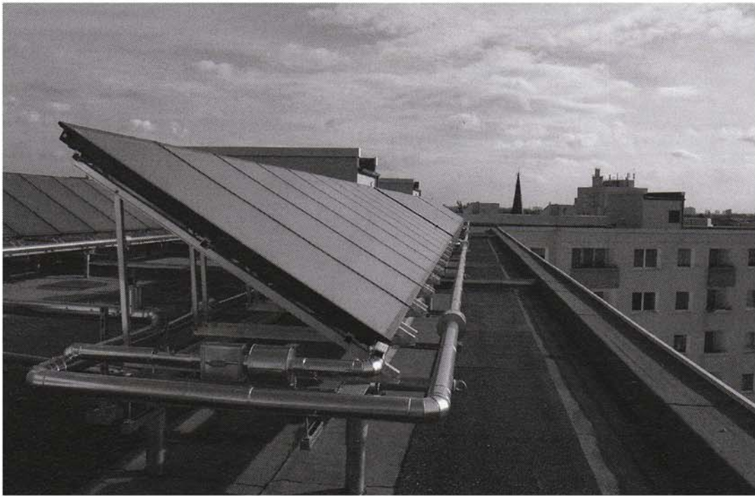
Bild 6. Solarthermischer Flachkollektoraufbau zur Heizungssanierung in Berlin-Reinickendorf, Quelle : Bundesverband Solarwirtschaft / Upmann
