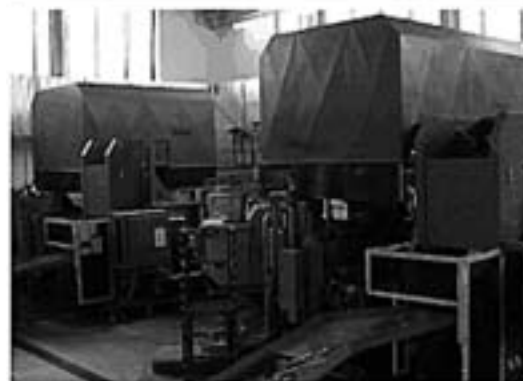
Bild 2. Komplettaustattung der Gießerei mit KMA ULTRAVENT 8000 Absauganlagen über den Druckgießmaschinen. Alle Filteranlagen verfügen über automatische Filterwaschanlagen. Die gereinigte Luft wird in den Arbeitsraum zurückgeführt. (KMA-Kurtsiefer Maschinen- und Apparatebau GmbH, Königswinter-Oberpleis).
